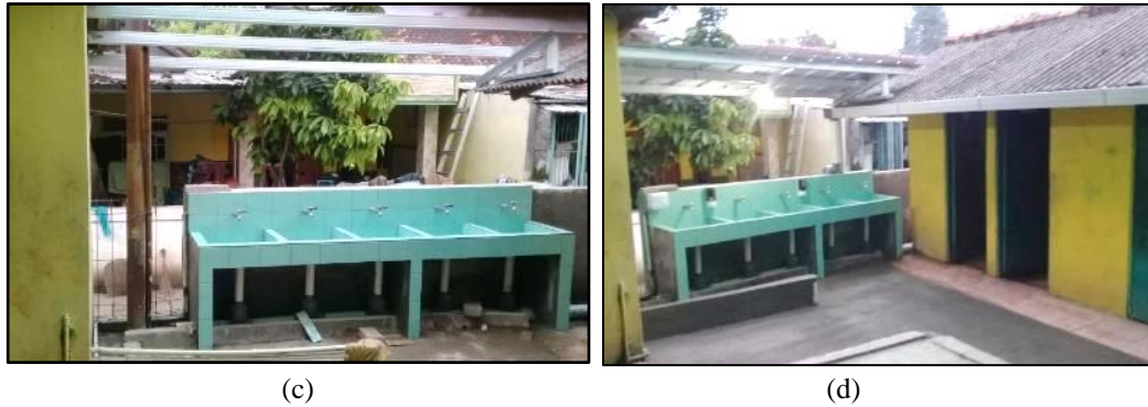
Gambar 3. Tahapan Pekerjaan Sarana Akses Cuci Tangan (a) Pengecoran (b) Pemasangan Keramik (c) Pemasangan Atap dan Talang (d) Hasil Akhir
